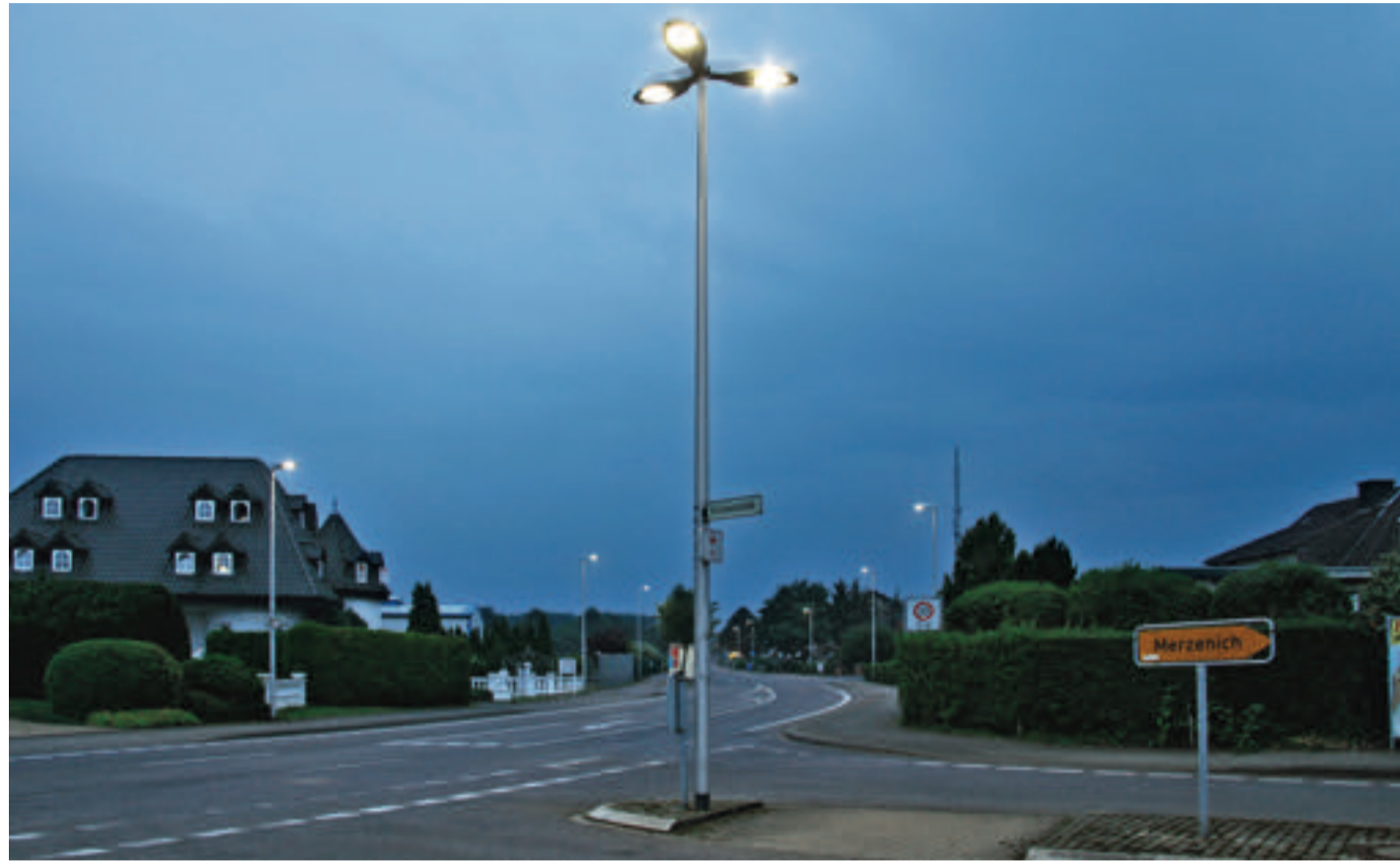
Effizient, klimaschonend und sicher: Eines der größten Projekte Deutschlands zu Smart City Lighting ist in der nordrhein-westfälischen Stadt Düren angesiedelt.
